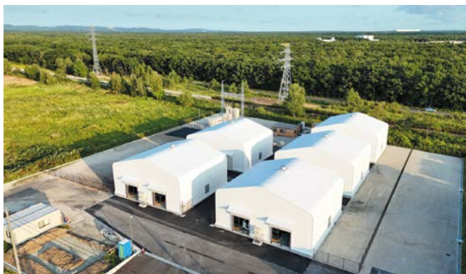
蓄電所「EVバッテリー・ステーション千歳」外観（北海道千歳市）
