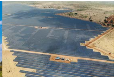
ReNew 社保有 Rajasthan 州 SECI III Solar power project 300MW
