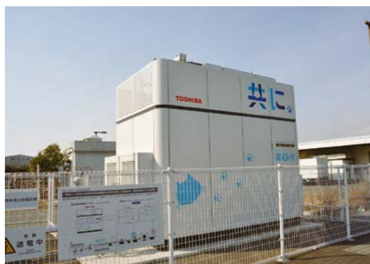
卸売市場に設置されている燃料電池発電設備
