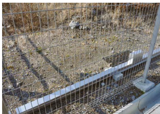
水素供給配管
