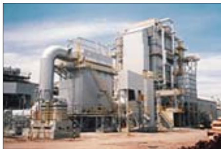
バイオマス発電プラント〔写真提供：三井物産〕
