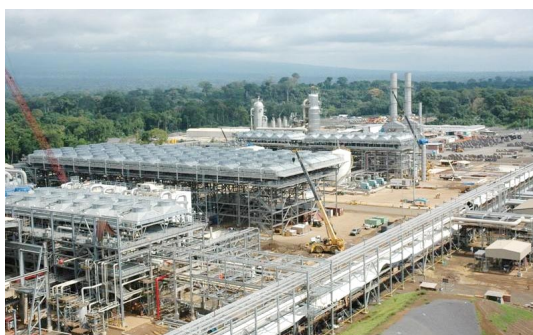
天然ガス液化プラント
