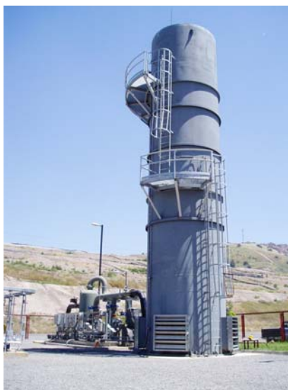
メタンガス回収／燃焼プラント
