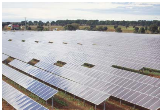
スペイン・トレドの発電設備（1.4MW）に三菱商事が納入した三菱重工製アモルファス太陽電池
