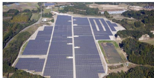
「未来創電球磨錦町」太陽光発電所の全景
