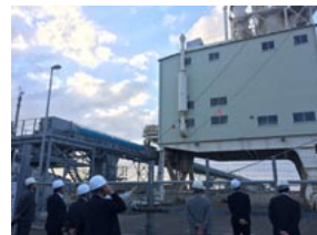
アルモリックス㈱が直江津港で原料荷揚げに使用するニューマ設備
