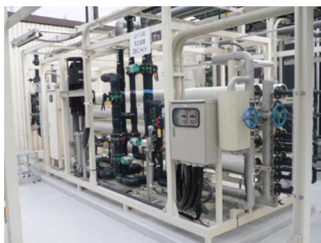
排水再利用RO膜装置 (900m 3 /日)
