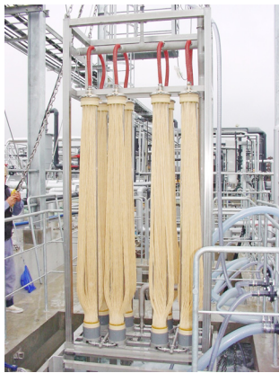
双日の排水リサイクルプラントで使用する MBR（膜分離活性汚泥法）モジュール
