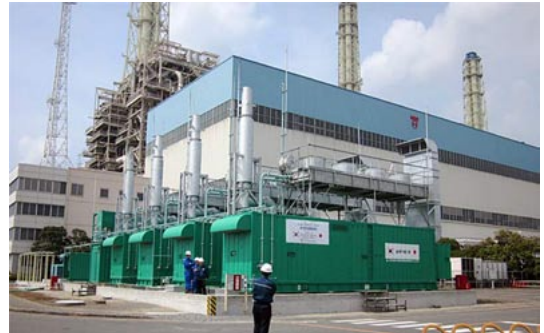
図4 緊急設置電源
