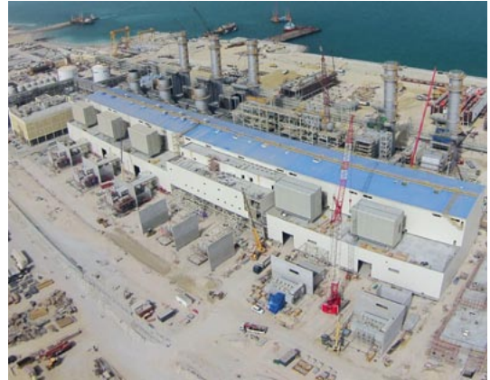
アズール・ノース発電・造水プラント全景
